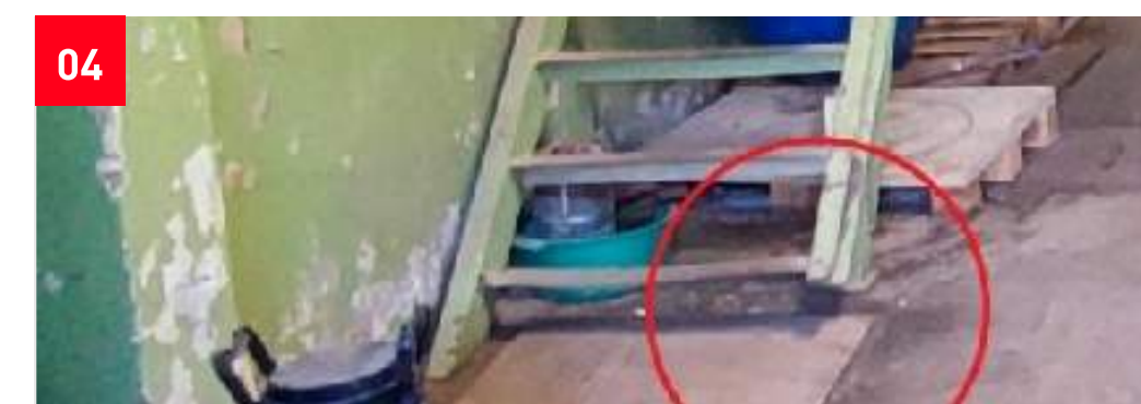
Отсутствие опоры лестницы
