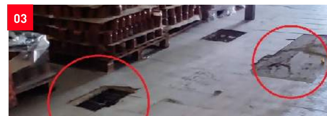
Нарушение целостности напольного покрытия
